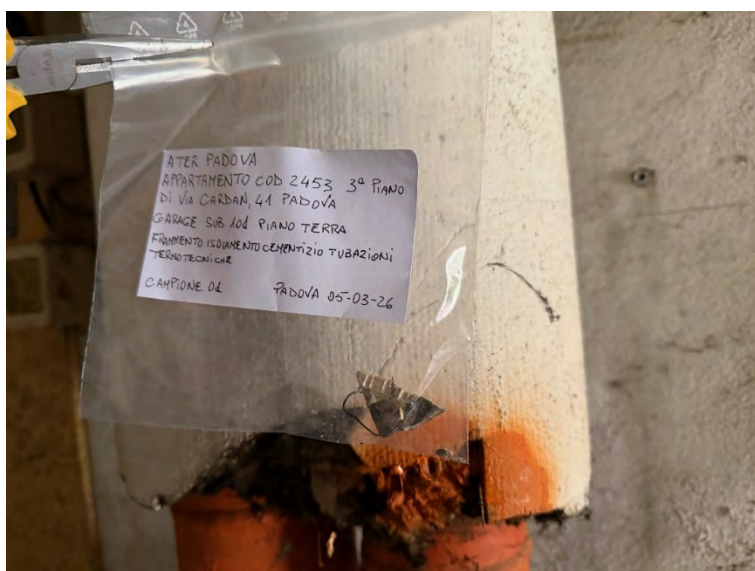
Foto 12 – campione 01 isolamento tubazione termotecnica garage
